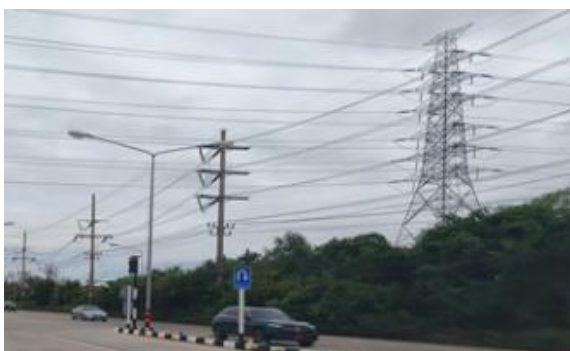
ระบบสายส่งไฟฟ้าแรงดันสูงของการไฟฟ้าส่วนภูมิภาค
