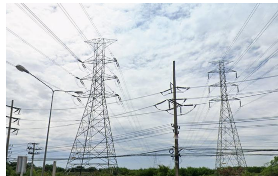
ระบบสายส่งไฟฟ้าแรงดันสูงของการไฟฟ้าส่วนภูมิภาค
