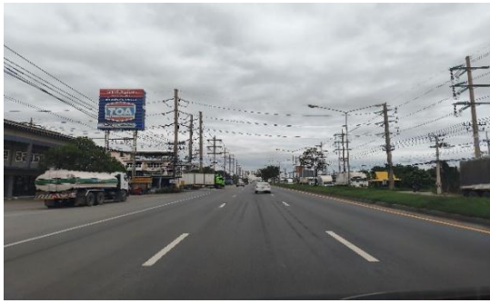
ระบบไฟฟ้าแสงสว่างริมทางและบริเวณเกาะกลาง
