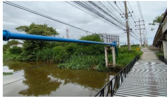
ระบบประปาริมทางหลวง
